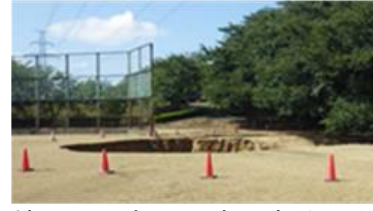
柿原トンネルの陥没事故現場
